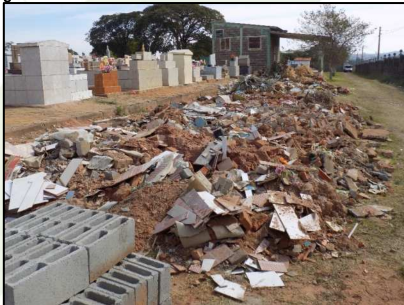
Figura 52 – rea de acondicionamento dos resduos Classe IV
