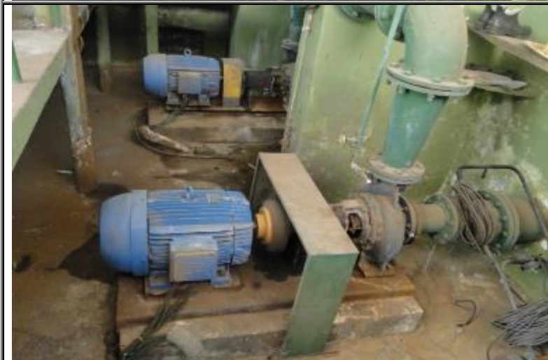
Figura 50 - Sistema de bombeamento
