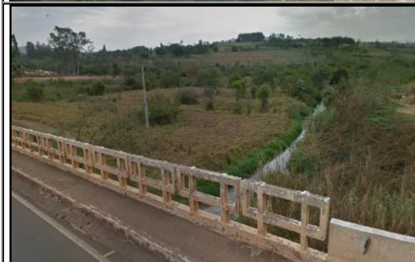
Figura 188 - Vista de uma Travessia sob o Rio Bonito.
