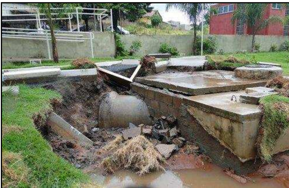
Figura 188 - Vista do rompimento dos dispositivos de drenagem.
