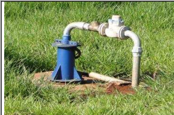
Figura 73 - Poço Tubular não ativado
