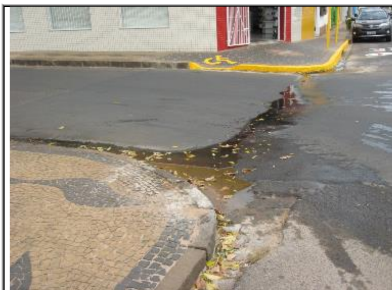
Figura 162 - Vista do empoçamento de água na Rua Bezerra Paez. Declividade longitudinal insuficiente e falta de dispositivo de captação de águas pluviais.
