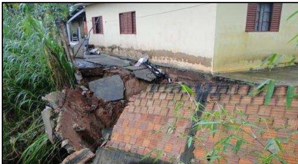
Figura 190 - Vista da Área de Risco e o deslizamento.
