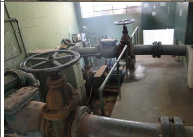
Figura 51 - Tubulações do sistema de bombeamento
