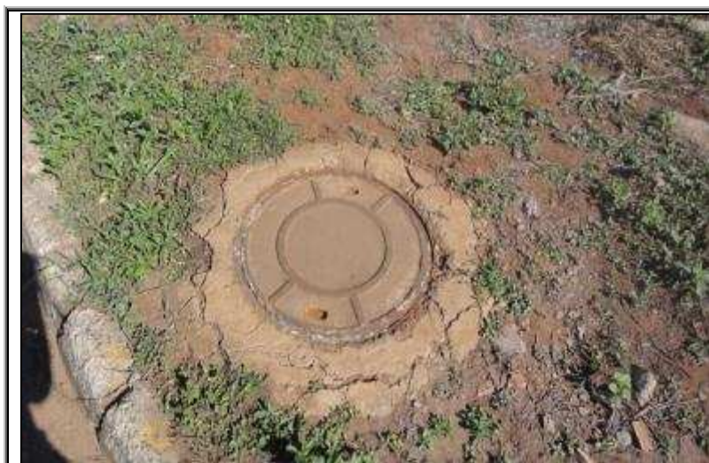
Figura 103 - PV fechado - ESTAÇÃO DE ESGOTOS-1 e localização do PV.
