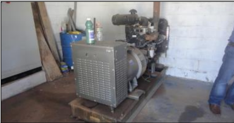
Figura 111 - Gerador - Estrutura implantada na estação elevatória de esgotos- 1.
