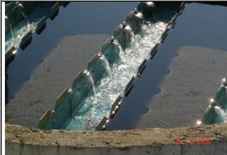
Figura 38 - Calhas de coleta de água filtrada
