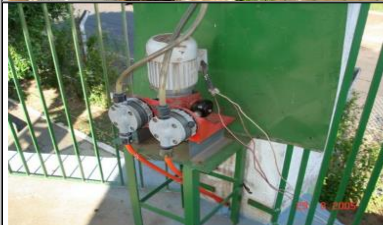
Figura 32 - Dosador de sulfato de alumínio
