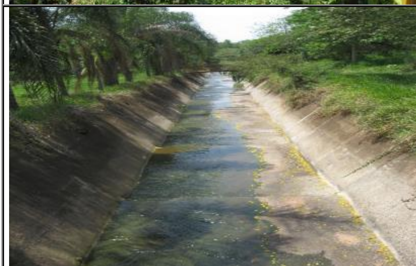
Figura 186 - Vista da canalização aberta trapezoidal do Córrego Tamanduá, afluente do Rio Bonito.
