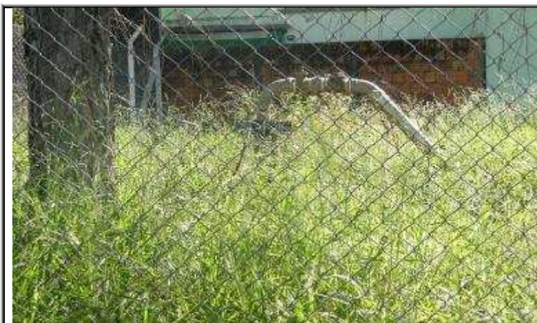
Figura 89 - Poço tubular com vegetação rasteira (situação não adequada) - Jardim Belém.
