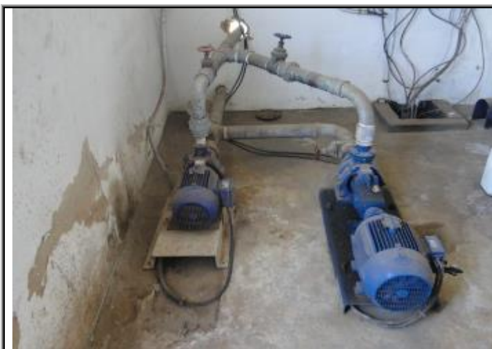
Figura 86 - Casa de bombas - Santa Cruz
