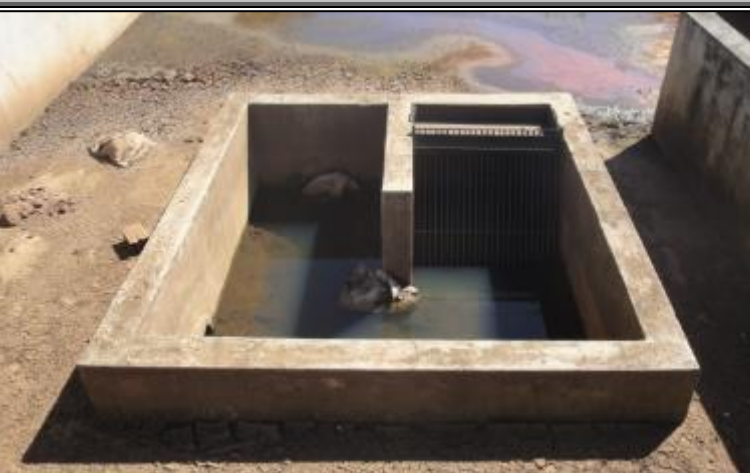
Figura 117 - Gradeamento – Caixa coletora de detritos (espaçamento de 50 mm) de Tratamento preliminar na EEE Final.
