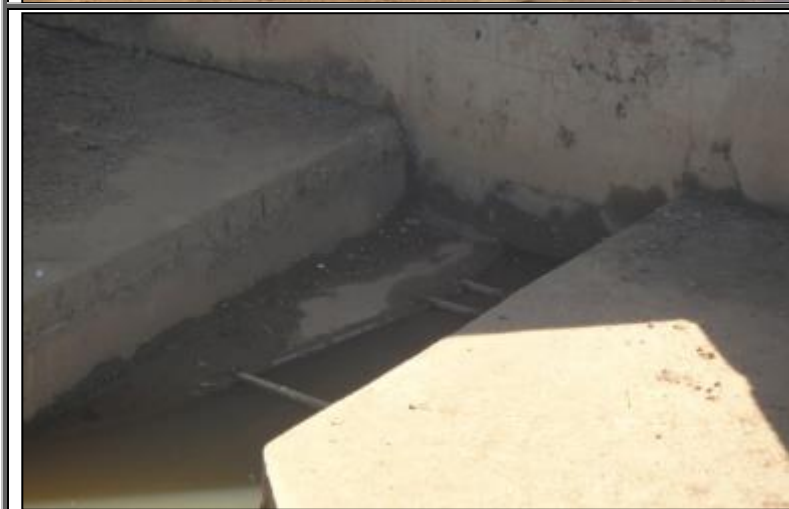
Figura 120 - Acúmulo de terra na caixa de areia de Tratamento preliminar na EEE
