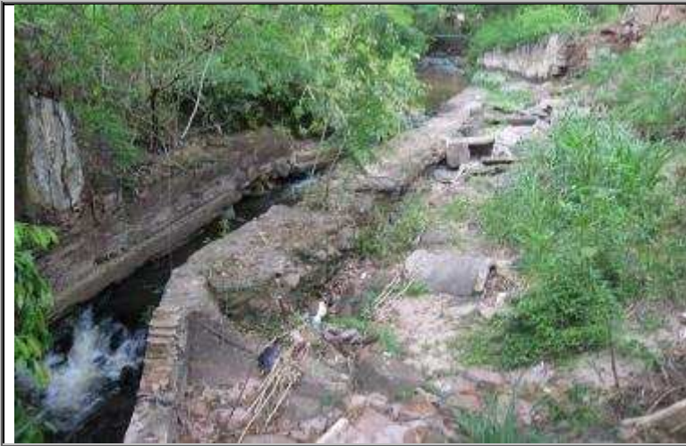
Figura 175 - Vista a montante da imagem anterior, no entanto no sentido oposto, demonstrando a situação da canalização e também o estrangulamento do Córrego da Prata.
