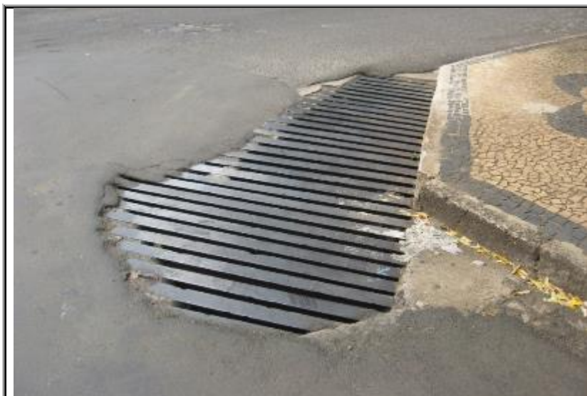
Figura 165 - Vista de um dispositivo de captação de águas pluviais. Manilha com diâmetro de 800 mm.
