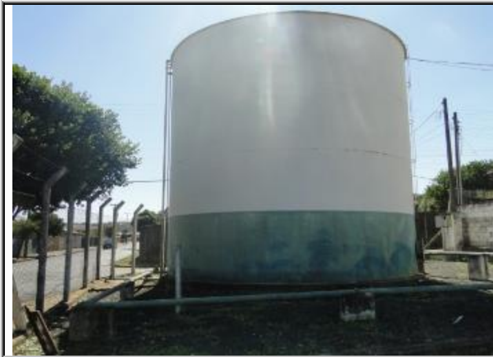
Figura 87 - Reservatórios Apoiado (200 m 3 ) - Santa Cruz
