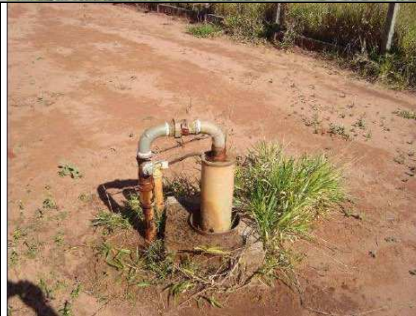
Figura 94 - Poço tubular com área limpa circunvizinha ao poço – situação adequada
