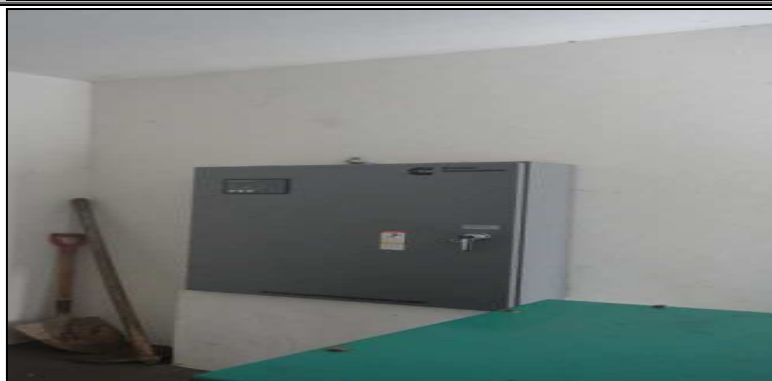
Figura 124 - Quadro comando elétrico das bombas - Estrutura implantada na EEE Final
