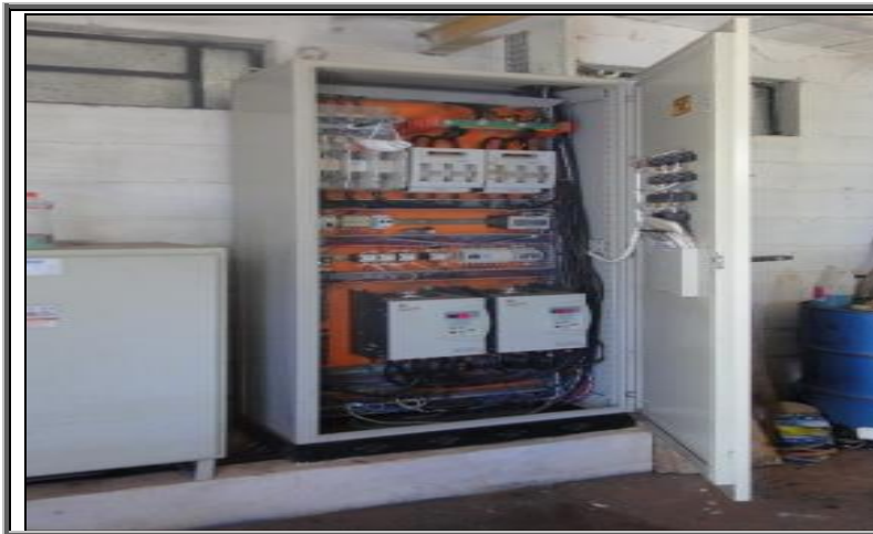
Figura 113 - Quadro de comando elétrico do gerador - Estrutura implantada na estação elevatória de esgotos-1.
