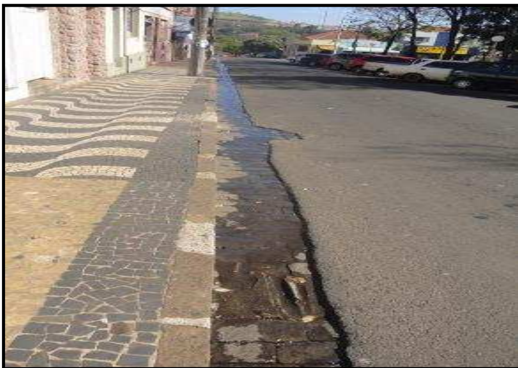
Figura 98 - Lançamento de águas cinzas nas sarjetas.
