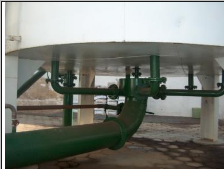
Figura 34 - Entrada de água coagulada no filtro
