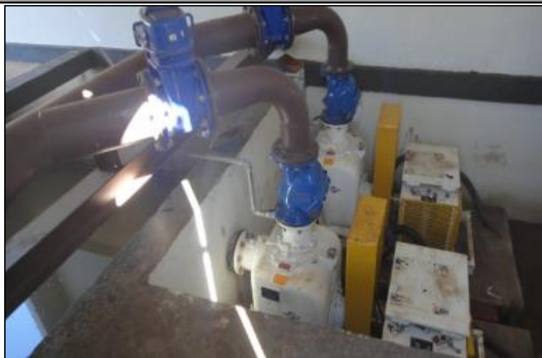
Figura 121 - Conjuntos motobomba - Estrutura implantada na EEE Final
