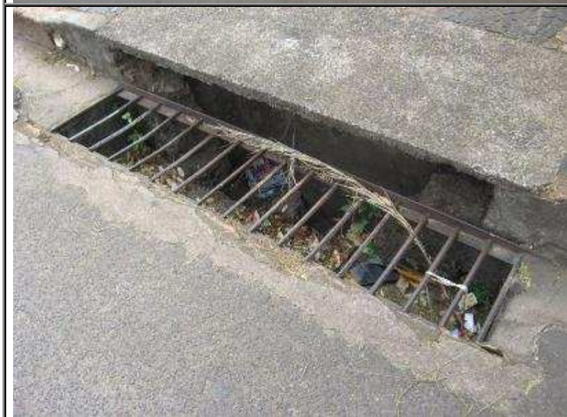
Figura 166 - Vista de um dispositivo de captação de águas pluviais. Duas manilhas com diâmetros de 300 mm.
