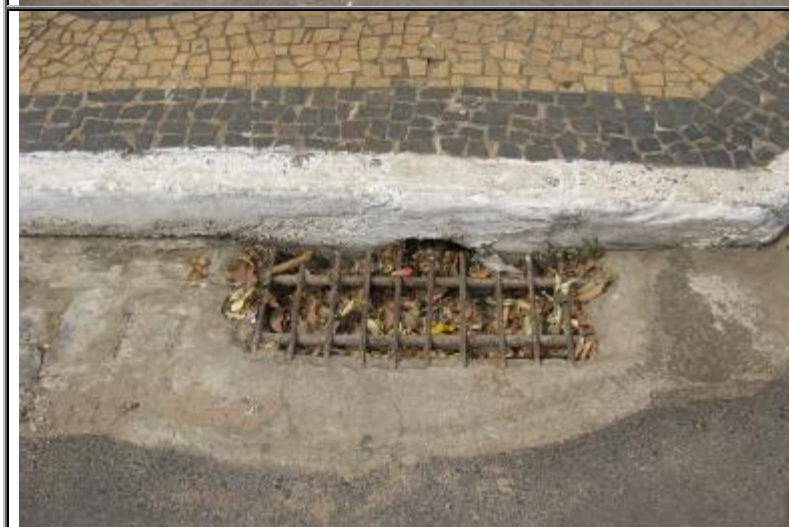
Figura 160 - Vista do dispositivo de captação de água pluvial, obstruída pelo acúmulo de sedimentos e falta de manutenção.
