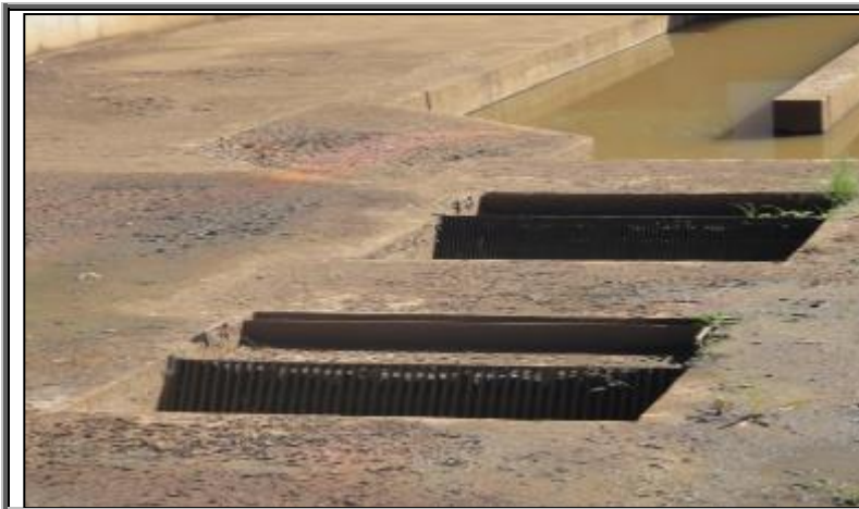
Figura 118 - Gradeamento – Malha grossa (espaçamento de 40mm) e fina (espaçamento de 20mm) de Tratamento preliminar na EEE Final.
