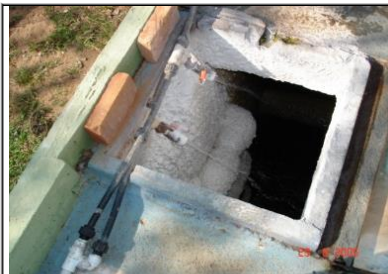
Figura 43 - Ponto de dosagem de cal hidratada
