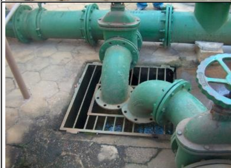
Figura 41 - Ponto de descarga de lavagem dos filtros
