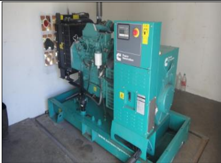
Figura 122 - Grupo gerador - Estrutura implantada na EEE Final
