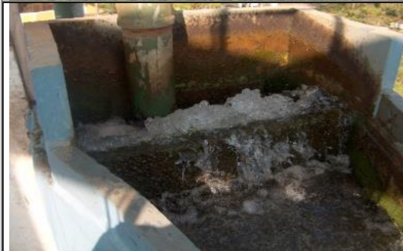
Figura 29 - Câmara de entrada água bruta
