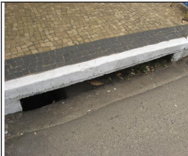
Figura 152 - As bocas de lobo não se encontram com grelhas e as redes de águas pluviais tem diâmetro de 300 mm nesse ponto.
