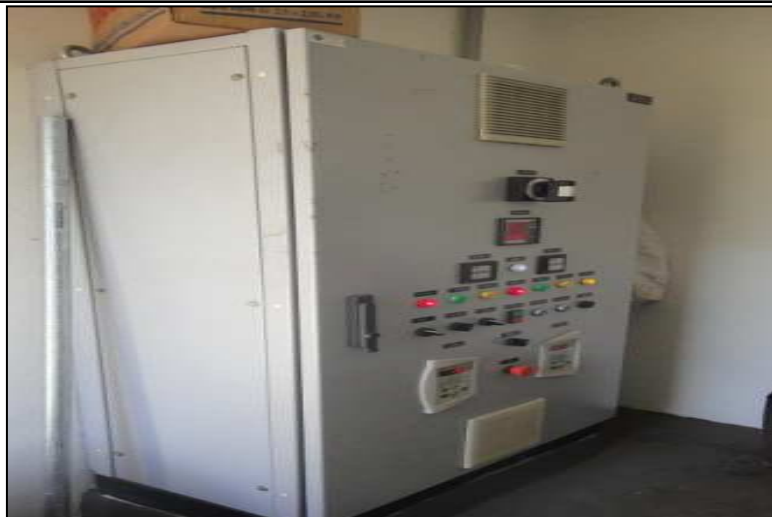
Figura 123 - Quadro comando elétrico do gerador - Estrutura implantada na EEE Final
