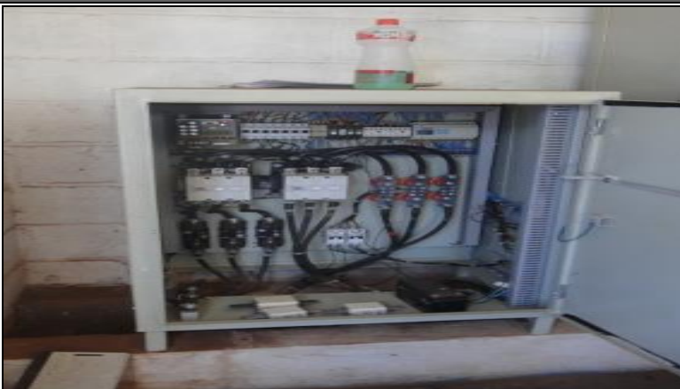
Figura 112 - - Quadro de comando elétrico das bombas - Estrutura implantada na estação elevatória de esgotos- 1.
