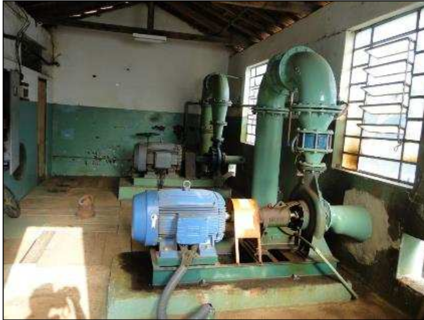
Figura 25 - Casa de bombas do sistema de captação de água da Represa Rosária.
