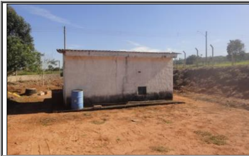
Figura 107 - Rachaduras - Estação elevatória de esgoto-1
