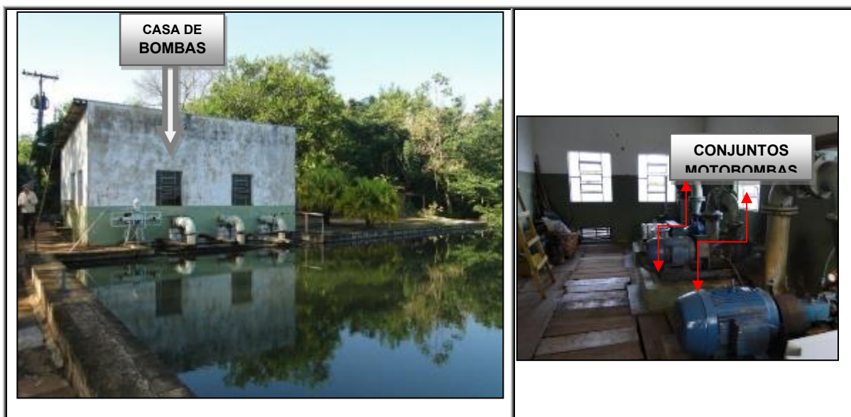
Figura 27 - Sistema de captação de água e casa de bombas da Represa Calmon.
