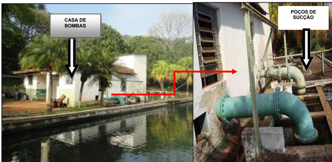
Figura 24 - Sistema de captação de água na Represa Rosária.
