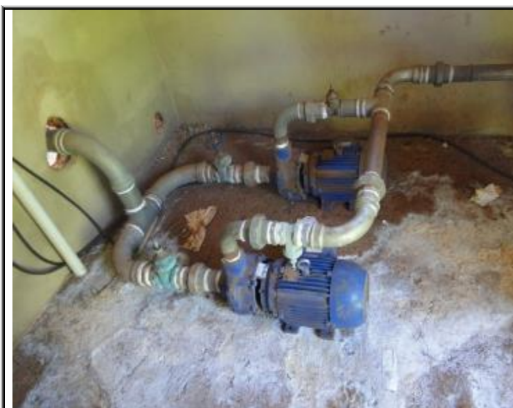
Figura 76 - Detalhe de bombas instaladas na casa de química
