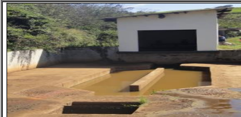
Figura 119 - Caixa de areia de Tratamento preliminar na EEE Final.
