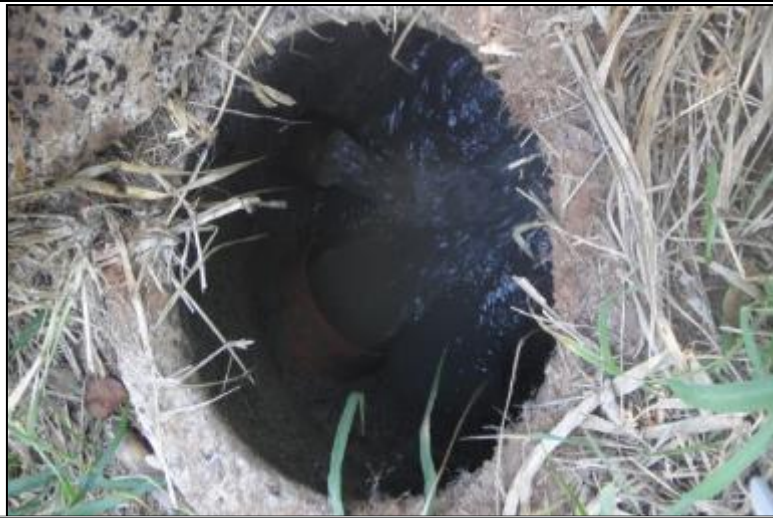
Figura 104 - Chegada da tubulação de recalque da EEE1 e da rede coletora dos bairros adjacentes. - ESTAÇÃO ELEVATÓRIA DE ESGOTOS-1 e localização do PV.
