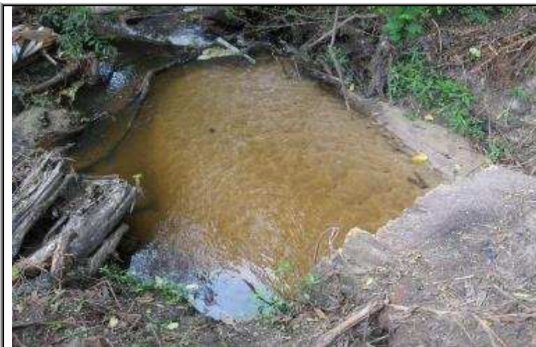
Figura 174 - Vista do lançamento do Córrego Buraco da Onça no Córrego da Prata. Nota-se o talvegue assoreado
