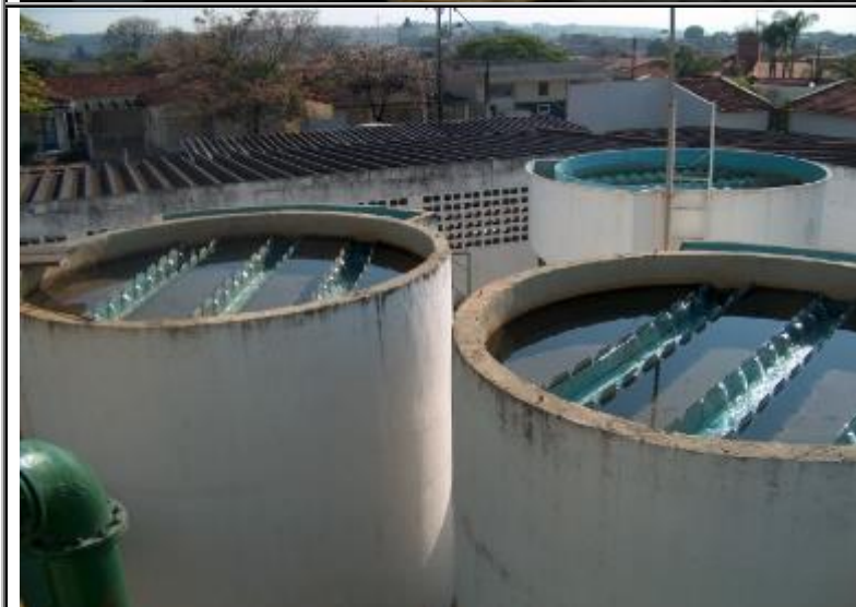
Figura 36 - Detalhes dos filtros descobertos
