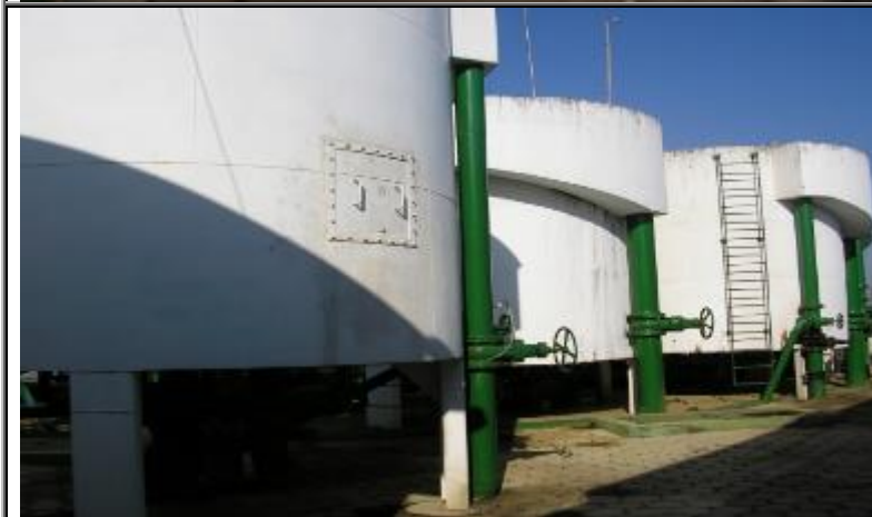
Figura 35 - Vista lateral dos filtros
