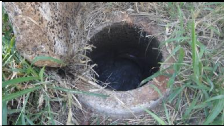
Figura 105 - Saída do esgoto por gravidade.- ESTAÇÃO ELEVATÓRIA DE ESGOTOS-1 e localização do PV.
