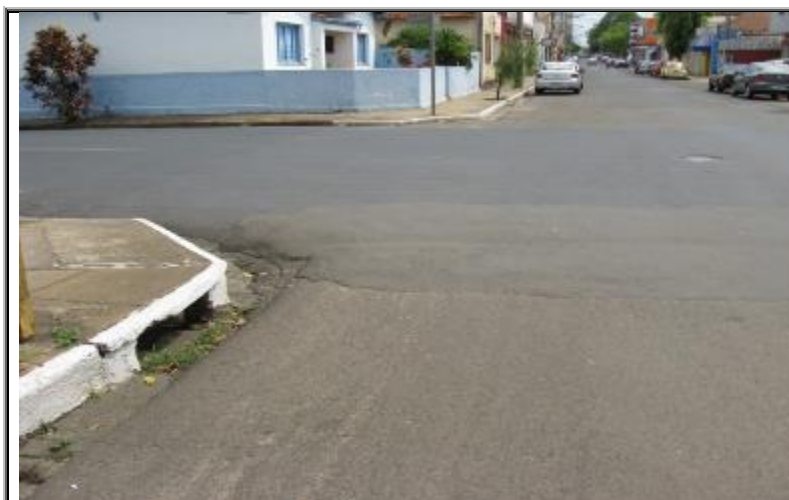
Figura 159 - Vista do trecho objeto de estudo. Local passível de inundações em razão do subdimensionamento da rede de microdrenagem.
