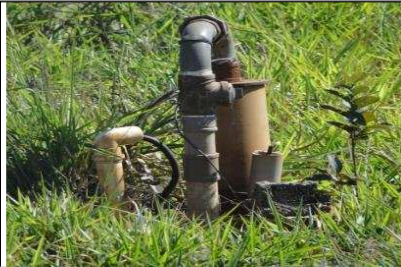
Figura 93 - Poço tubular com vegetação rasteira – forma inadequada
