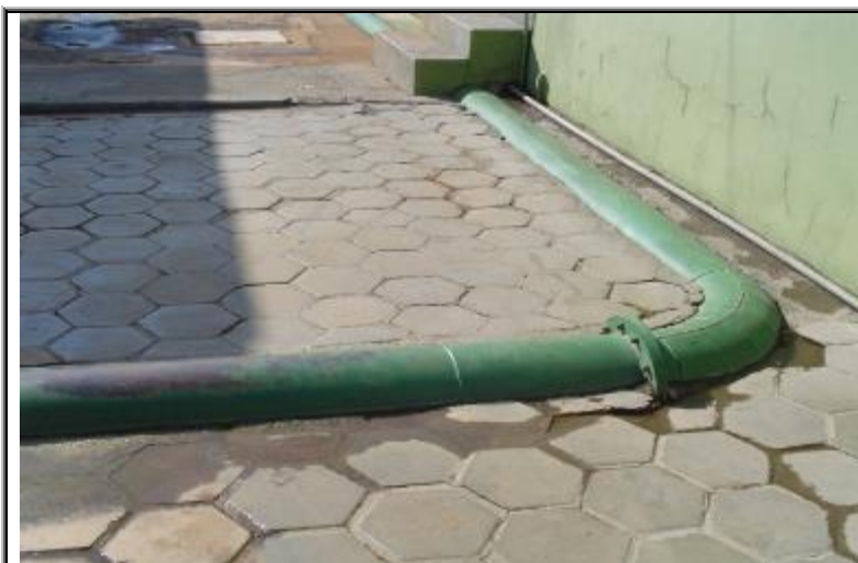
Figura 40 - Conduto de água filtrada
