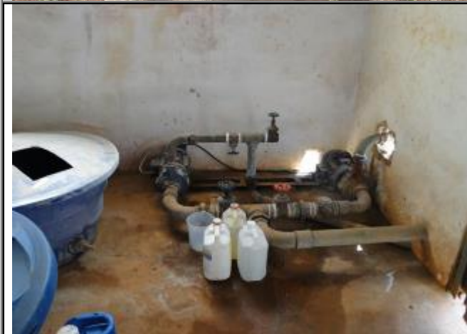
Figura 60 - Conjunto motobomba para recalque para o reservatório Apoiado/Elevado
