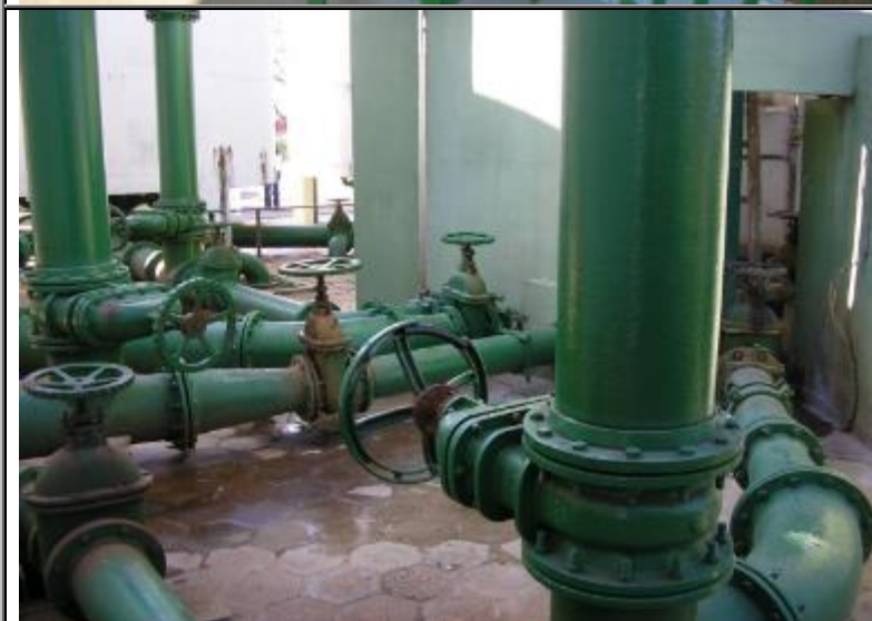
Figura 33 - Distribuição de água coagulada
