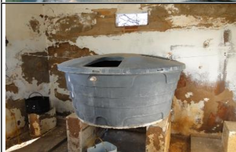
Figura 44 - Tanque de armazenamento e dosagem de hipoclorito de sódio
