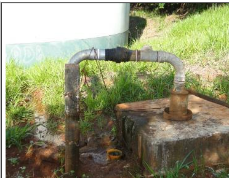
Figura 72 - Poço Tubular 1 ativado
